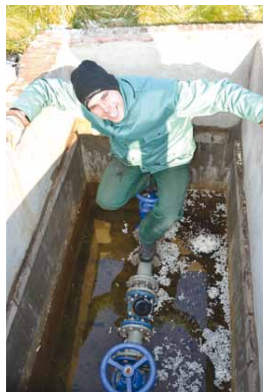
Afsluiter van de landbouw waterleiding in de werkput van Evides.
